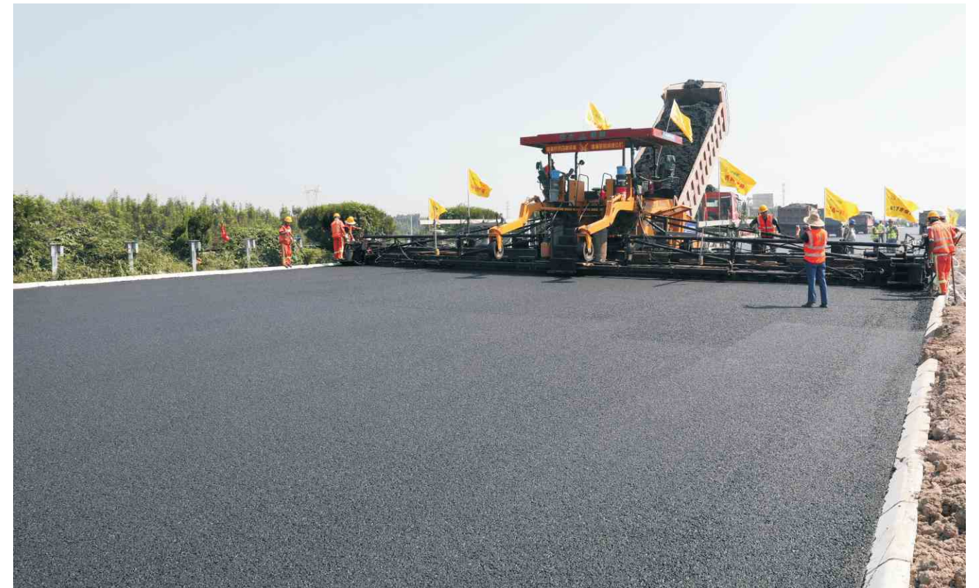
“四改八一字坡、无纵缝” 18.75米宽整体成型摊铺的路面左边部压实效果
